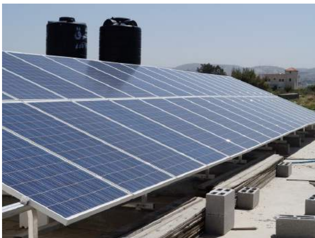
Panneaux sur le toit d'une école de Beit Sira
